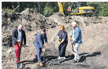
Start inwestycji i wbitie pierwszej łopaty. Od lewej: kierownik budowy Leszek Zmełty, prezydent Marcin Krupa, prezes firmy GRETASPORT Ilona Stańczyk oraz mieszkańiec Piotrowic
