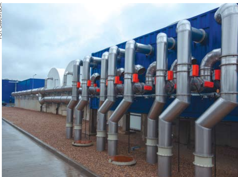
Nowo wybudowana instalacja do biologicznego przetwarzania odpadów jest częścią regionalnej instalacji.
