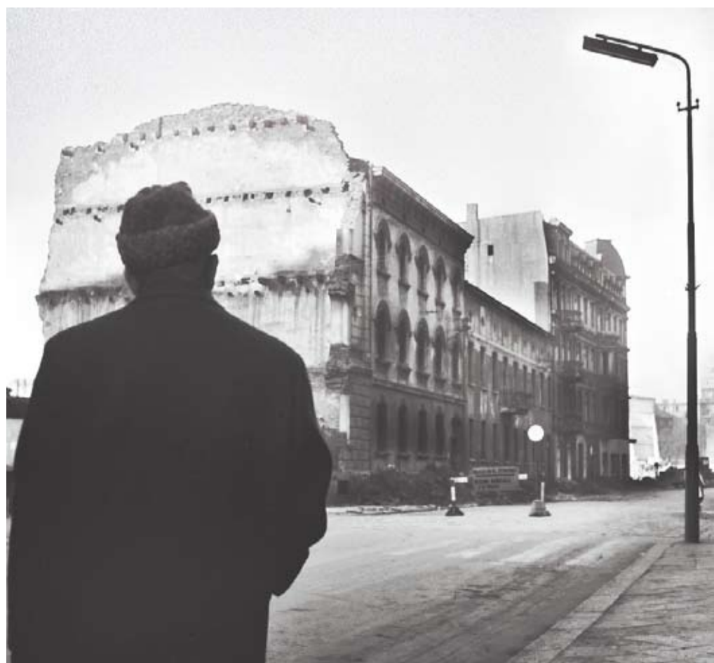
Antoni Wojda, ówczesny Przewodniczący Miejskiej Rady Narodowej, obserwuje wyburzenia kolejnego fragmentu budynku, w którym mieścił się młyn
